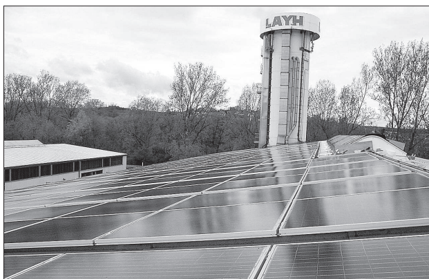
In Oberboihingen werden bei Holzbau Layh 2005 voraussichtlich 60 000 Kilowattstunden produziert.
